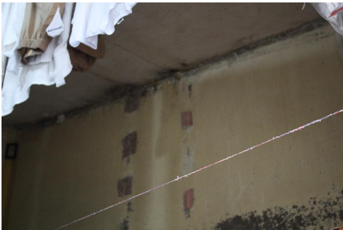
Infiltração no teto de celas
