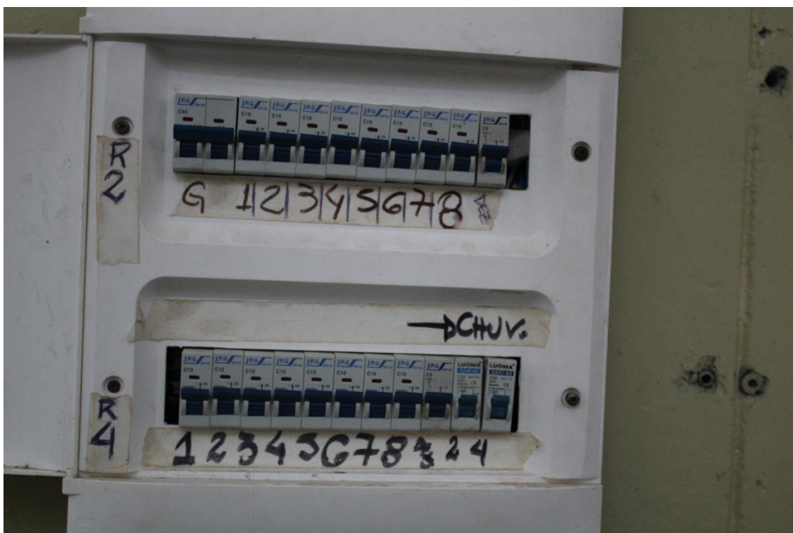
Disjuntores de aquecimento de chuveiros
