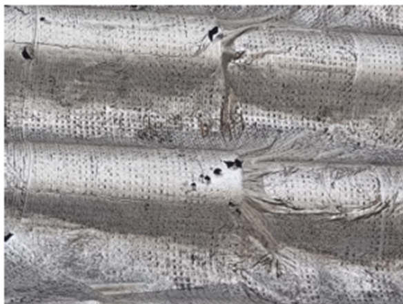
Foto 11 – Ampliação da manta asfáltica aluminizada deteriorada: com deformação, furos e fissuras
