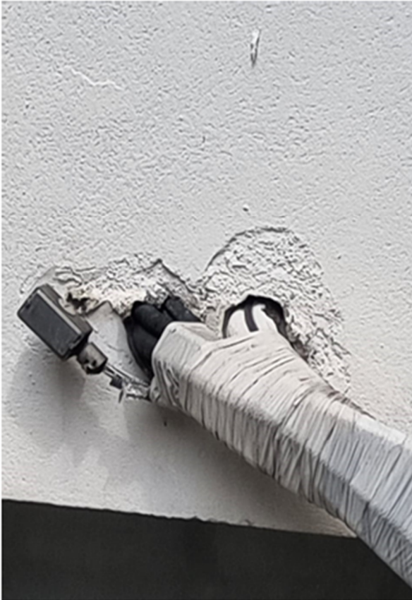
Foto 08 – Ampliação da entrada das tubulações de ar-condicionado na parede indicam que os furos não estão adequadamente vedados
