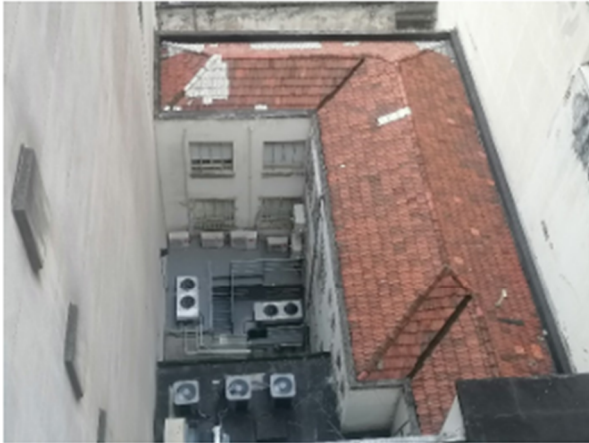
Foto 01 - Vista da cobertura sobre o 2º andar. O telhado apresenta telhas cerâmicas tipo francesa envelhecidas e com diversos remendos
