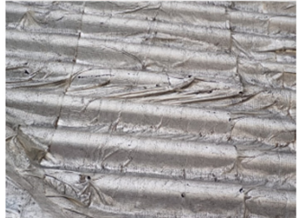
Fotos 09 e 10 – Constatação de pouco espaço entre a borda das telhas e a calha. Manta asfáltica aluminizada deteriorada, com deformações e diversas fissuras
