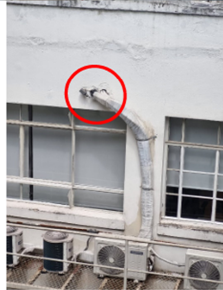
Fotos 06 e 07 – No detalhe aberturas realizadas na parede para a passagem das tubulações de ar-condicionado
