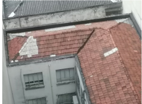
Foto 02 - Vista da cobertura sobre o 2º andar. O telhado apresenta telhas cerâmicas tipo francesa envelhecidas e com diversos remendos
