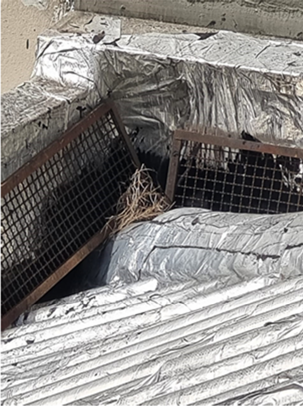
Foto 13 – Detalhe da manta aluminizada instalada sobre rufos, calhas e telhas da cobertura deteriorada. Fechamento em tela a fim de impedir a passagem de detritos
