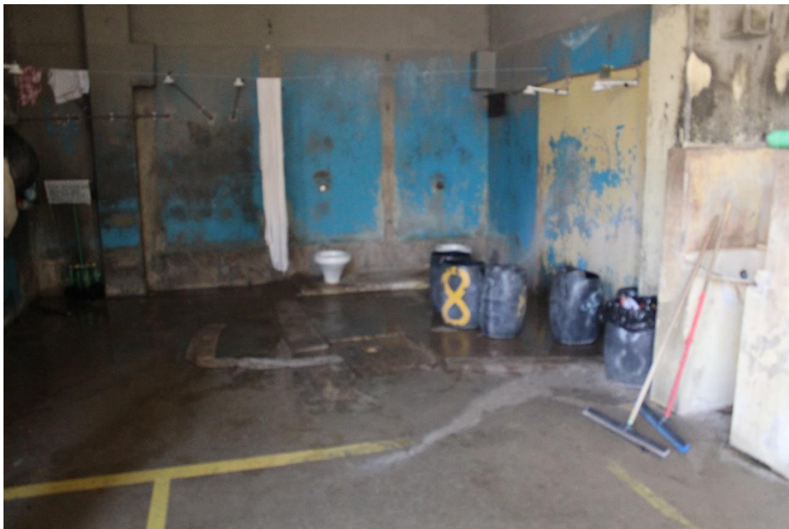
(condições dos chuveiros nos raios, sem proteção)
