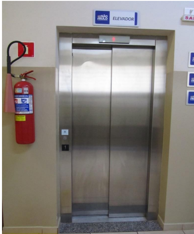
Elevador instalado na área administrativa da unidade
