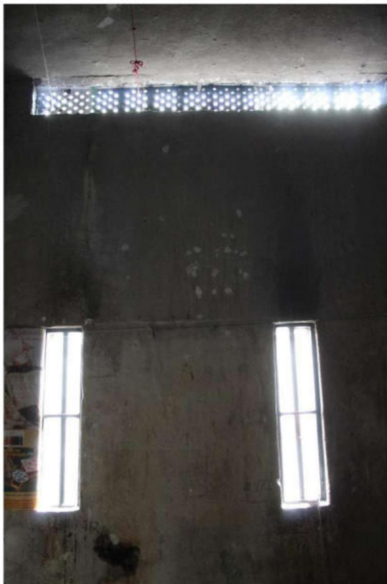
Detalhe para a pequena ventana que possibilita um mínimo de ventilação no fundo das celas
