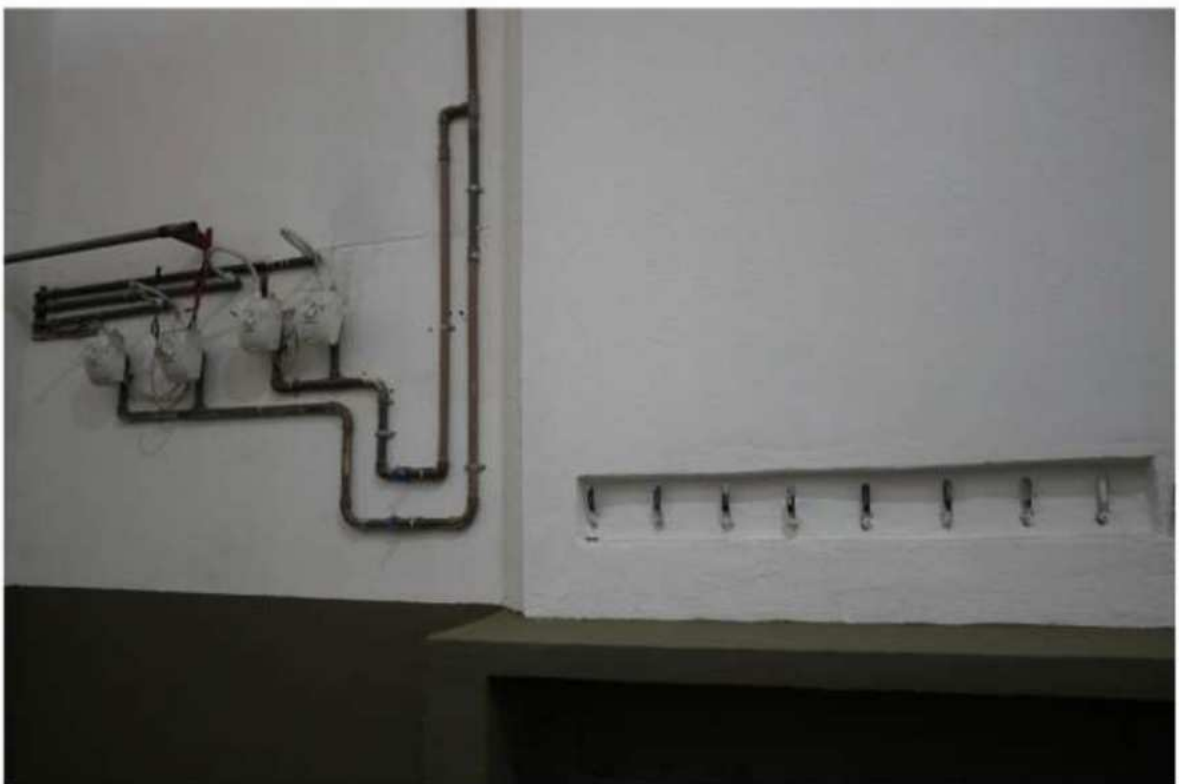
Controle dos chuveiros quentes localizados no corredor central da unidade
