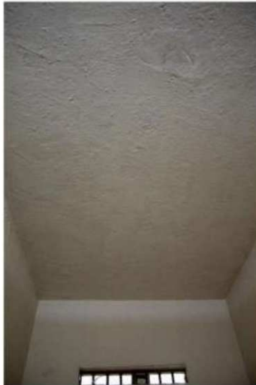
Detalhe para a ausência de iluminação artificial no interior das celas do setor disciplinar
