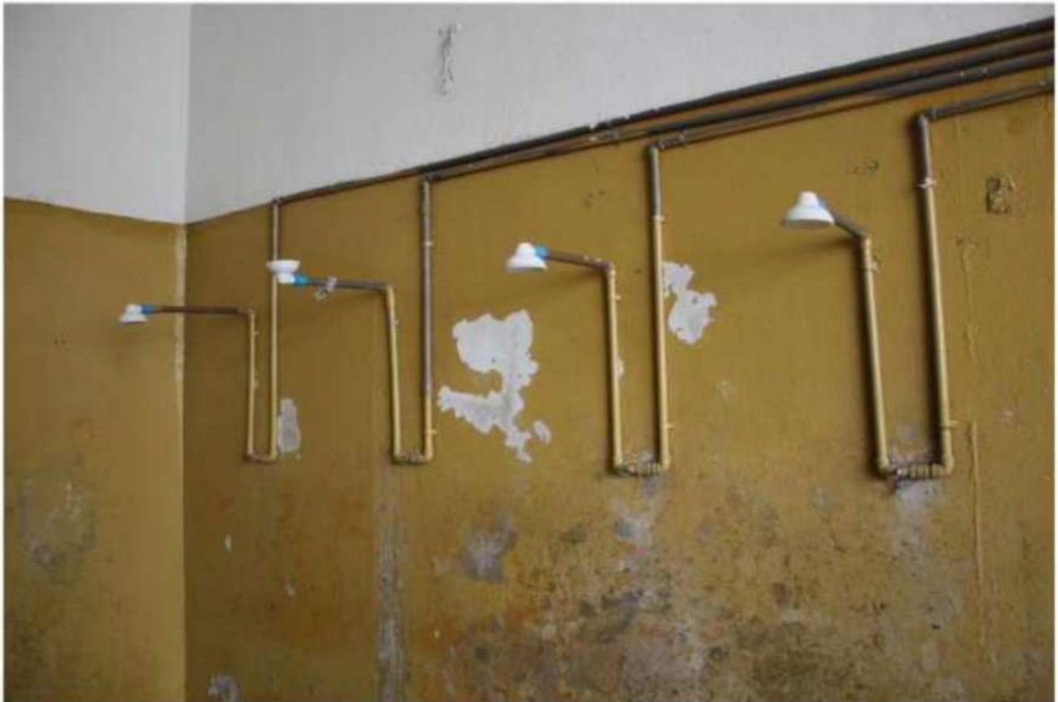
Detalhe para o segundo chuveiro com água quente que estava sem funcionamento
