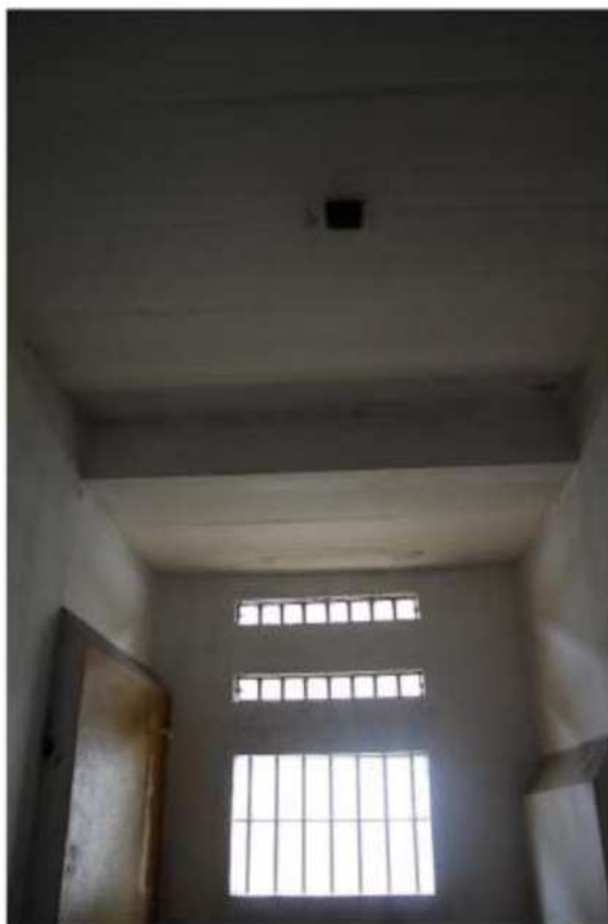
Detalhe para a ausência de iluminação interna artificial na cela da enfermaria
