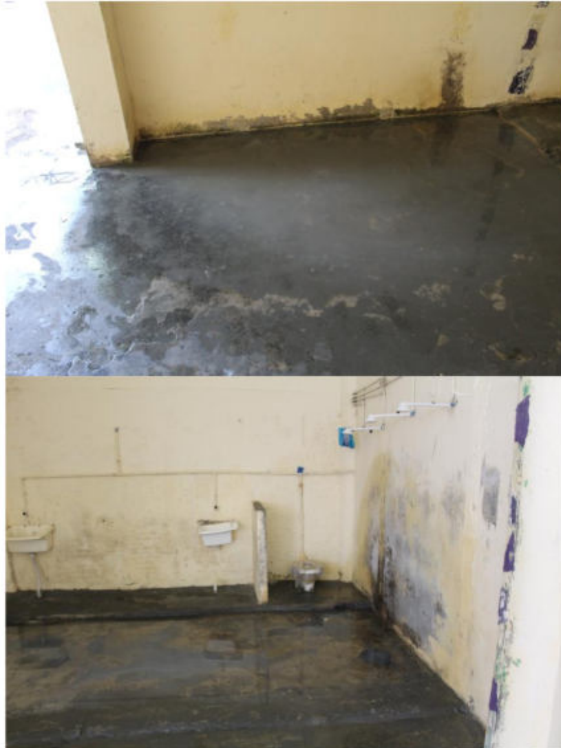
Fotos da área do banheiro do pátio de um dos raios. Só um chuveiro quente funciona, os ralos entupidos fazem a água empoeçar. Sanitário em péssimas condições.
