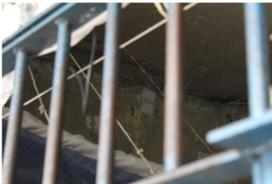
Fotos das paredes e teto de uma das celas, onde é possível observar as infiltrações e as tentativas de remendos feitos pelos presos.
